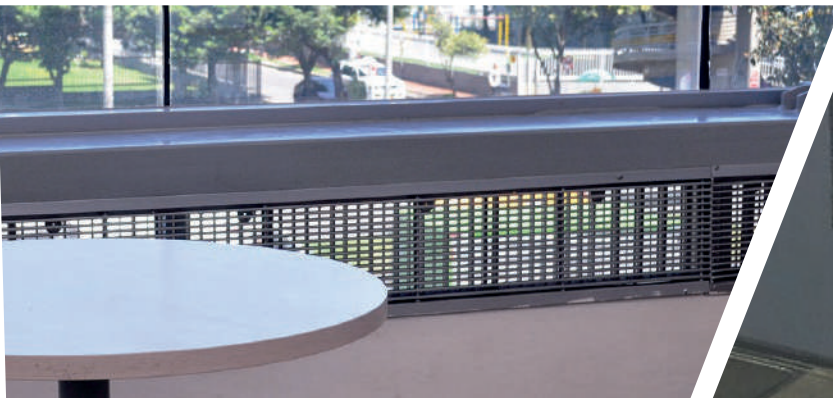
Rejillas ventilación interna
